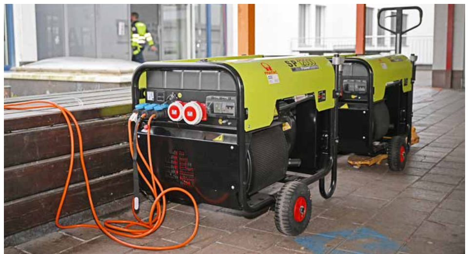
Generatoren lieferten den Strom für die Veranstaltung.
