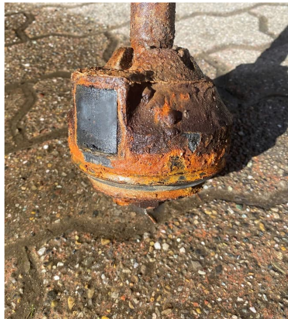
Service am Hauptventil eines Hydranten (Hyd. Nr. 5)
