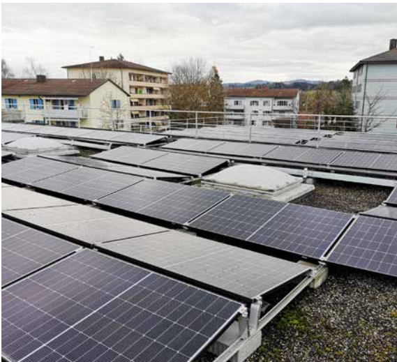
Blick auf die Photovoltaikanlage des Schulhaus Rietwis.
