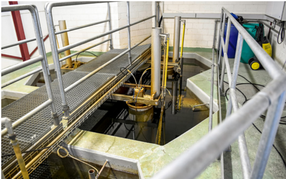
Im Filtergebäude sind grosse Dynasandfilter eingelassen. Die kleinen Sandkörnchen im Innern dieser Filter halten selbst feinste Verunreinigungen zurück.
