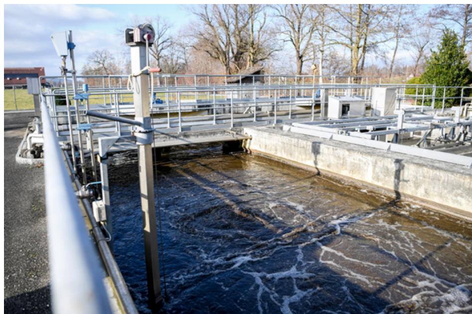
Blick auf eines der beiden Belüftungsbecken. Die hier enthaltene Bakterienmasse, der sogenannte Belebtschlamm, baut im Abwasser enthaltene Schmutzstoffe ab.
