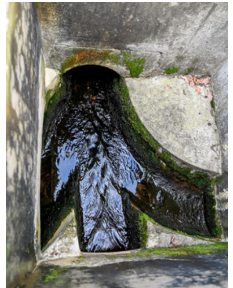
Fertig gereinigt: Das geklärte Wasser fliesst in den Aabach.
