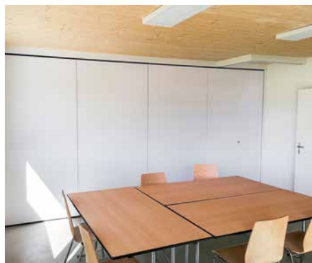
Mit der Schiebetrennwand kann der Aufenthaltsraum und das Sitzungszimmer miteinander verbunden oder getrennt werden.
