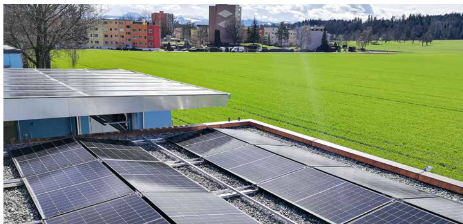
Ansicht der neuen Photovoltaikanlage auf dem Dach des Anbaus, sowie der Überdachung des Umschlagplatzes.
