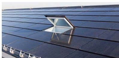
Dachflächenfenster in Solarmodulen
